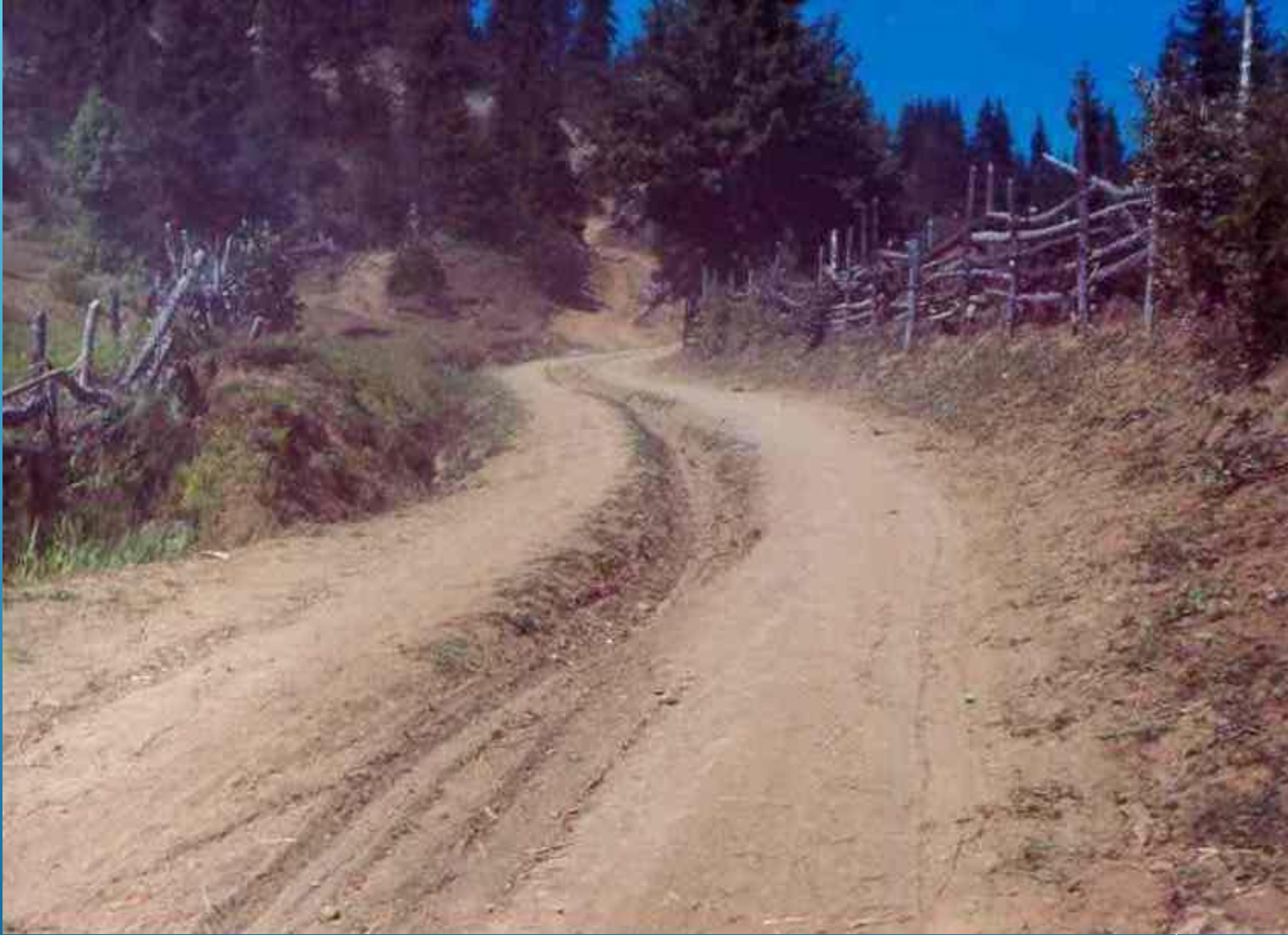
Üst Yapısı Deforme Olmuş Bir Orman Yolu
