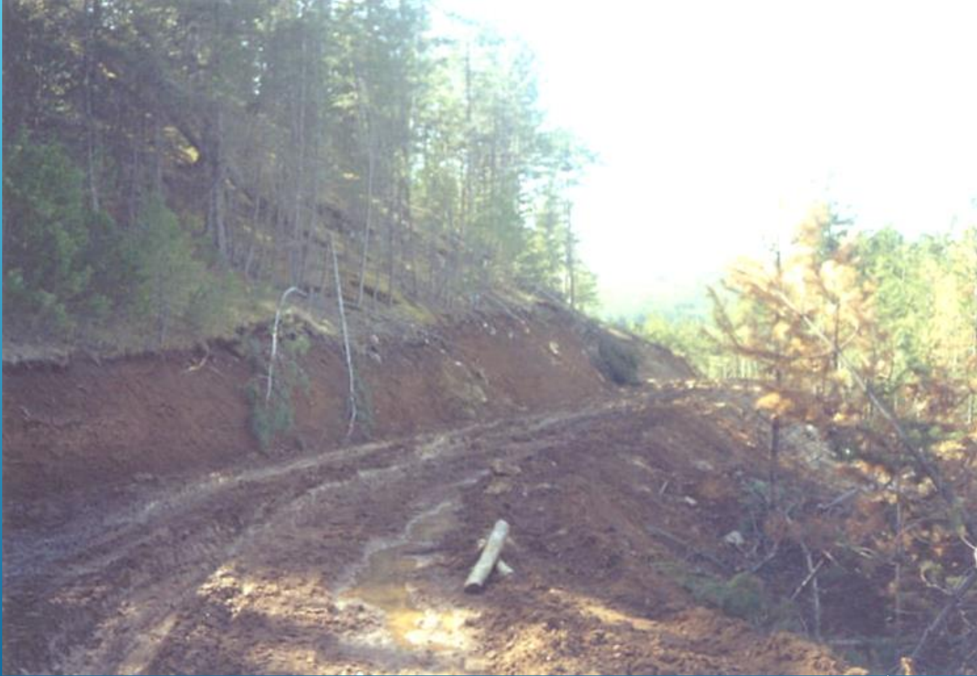
Gölgeli Bakıdan Geçirilmiş Drenaj Sorunu Olan Bir Orman Yolu
