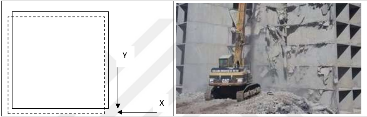
Şekil 14. Proje inşaat esnasında zemin hareketi sonucu yıkılan blok
